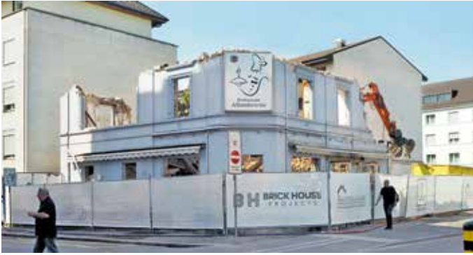
Verabschiedet hat sich das ehemalige Restaurant Albanbrücke von der Zürcherstrasse. Foto: Jörg Bertsch
