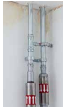
Grosse Freude herrscht über die «eleganten» neuen Heizungsrohre und den entstandenen Wasserschaden.
