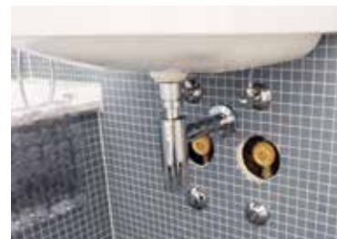
Zwangslüftung in der Toilette. Die Löcher sollen so bleiben, wie Figura zeigt. Fotos: Pu
